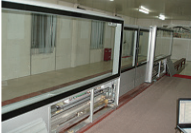
上海地铁 11 号线安全门系统
