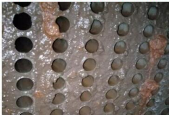
未使用臭氧处理壳管冷凝器前
