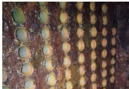
使用臭氧处理壳管冷凝器3个月后
