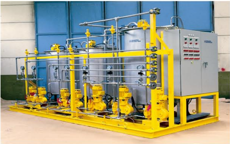
电厂加药装置
