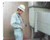
管道内的风速、压力等测试
