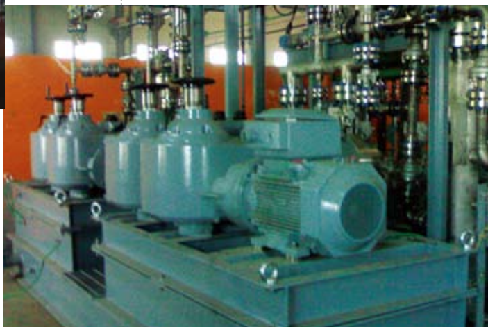
■ 海上石油平台：化学药剂注入撬装置 絮凝剂、缓蚀剂、阻垢剂投加
