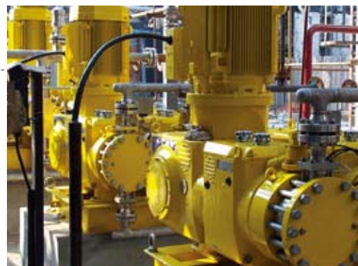
■ 化工：甲胺/二甲基甲酰胺 (DMF)项目氨水/甲醇投加
