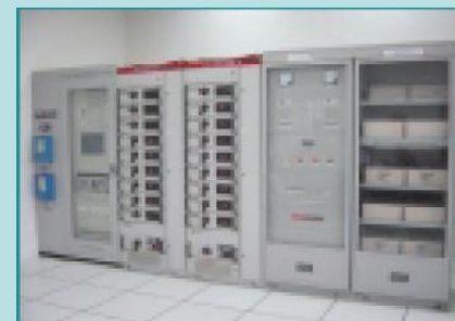
增压水泵控制机房
