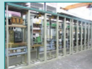
宝钢钢管厂ERW 项目整流/逆变柜
