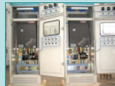
梅山矿水泵变频柜
