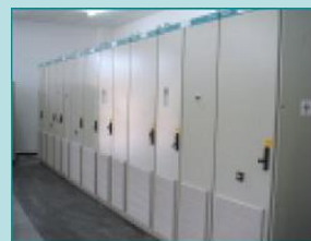
600KW 变频柜机房
