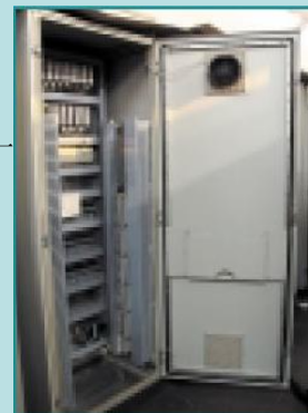
广州越堡水泥PLC柜
