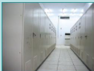
控制室（两条线的移钢、大包回转、拉矫、运输等传动控制设备
