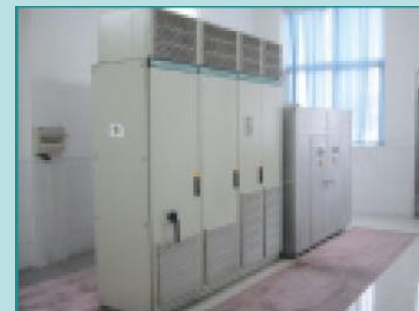
江阴水厂 800KW 变频调速柜
