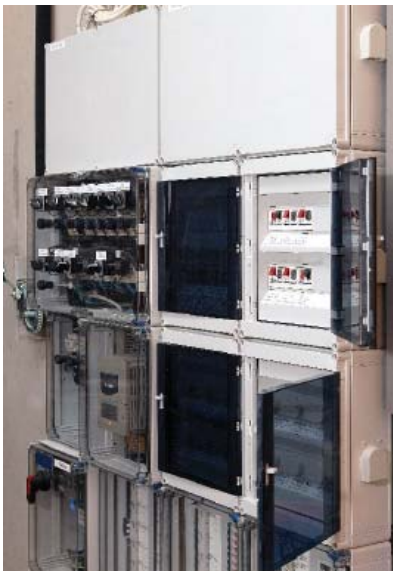
一个典型的电盘组装完成图片
