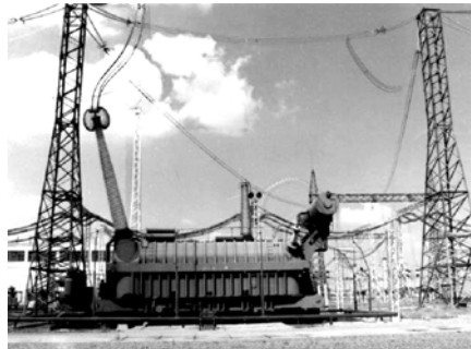
图 2 前苏联 667 MVA/1 150 kV 特高压变压器 Fig. 2 667 MVA/1 150 kV UHV transformer of the Soviet Union
