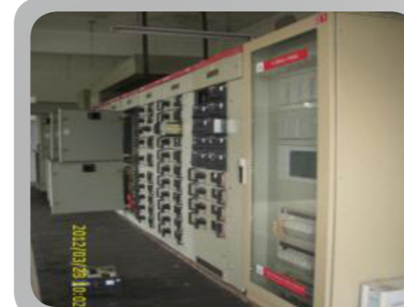
开源 DCS 主控站
