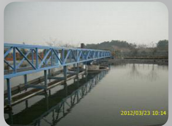
开源污水沉淀池
