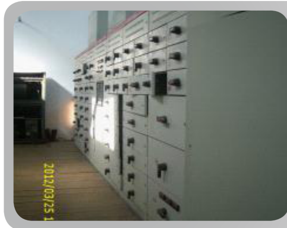
天乾科技 PLC 控制室
