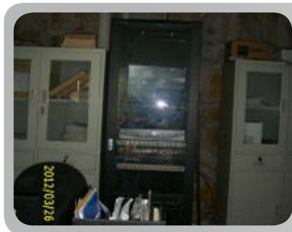
同济生态园监控系统
