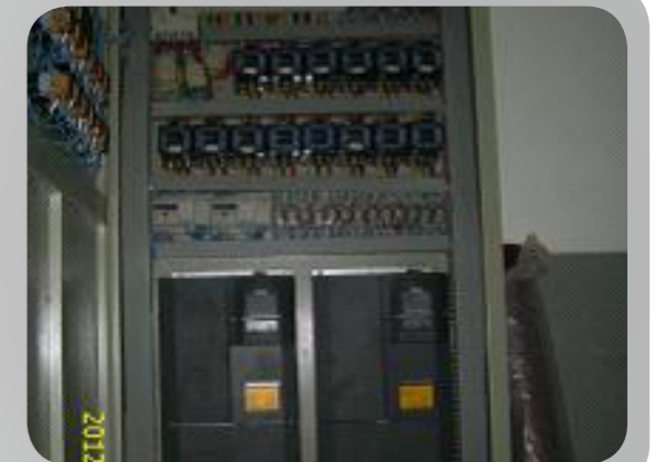
同济中央空调 PLC、变频控制系统
