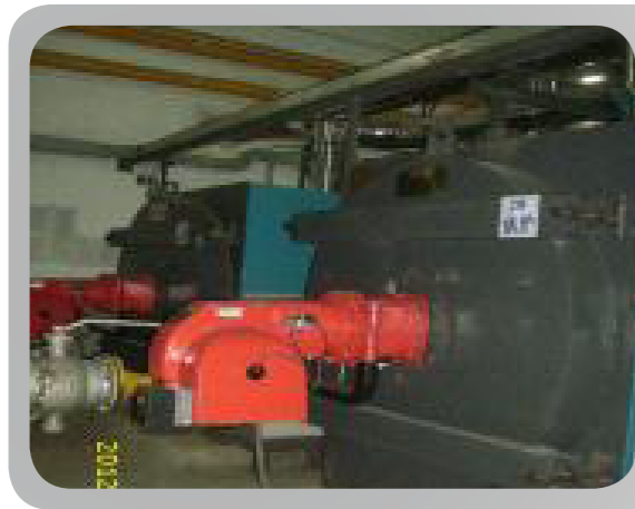
同济锅炉控制系统
