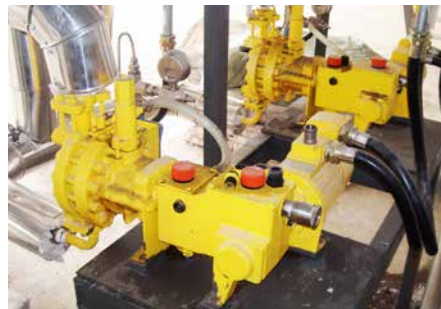
▲ 石化：催化剂注入泵
