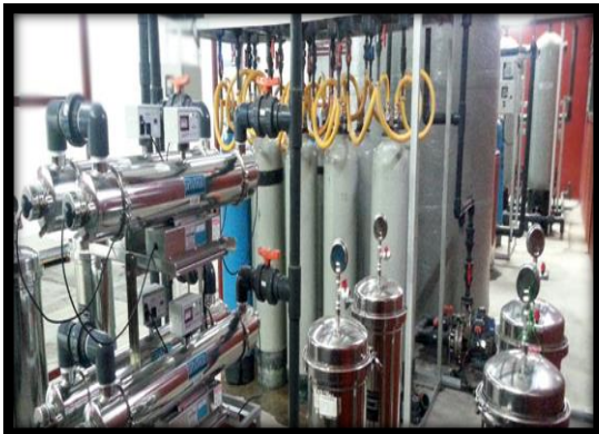
DI Water System
